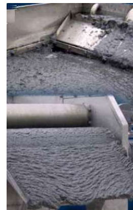
FANGOS DESHIDRATADOS MEDIANTE HIDROFIM
